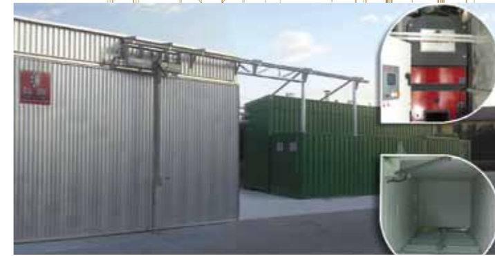
Centrale Termica su Container
