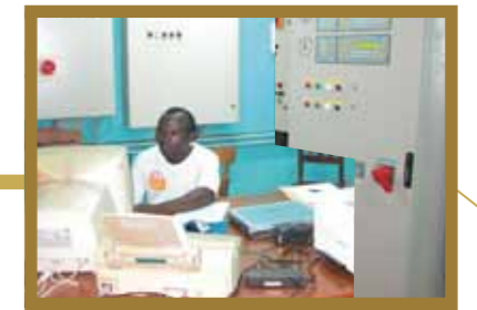
Gestione Computerizzata dell'Impianto
