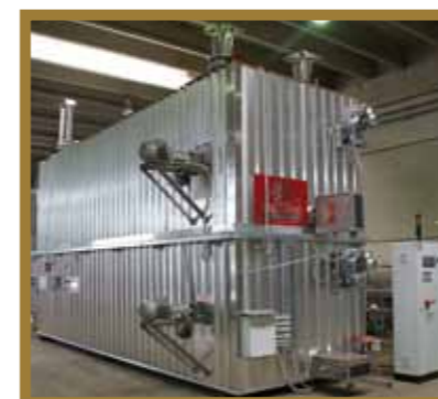
Impianto per il Trattamento Termico
