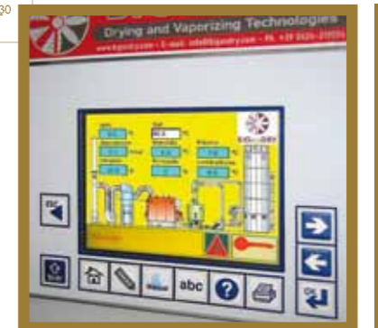
Sistema de Control
